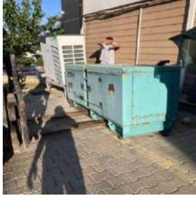
Aşevi jeneratör bakımı
