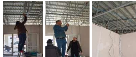
Çınarlı Mahallesinde yeni açılan kreşe internet bağlantısı, altyapı ve güvenlik kamerası sistemi
